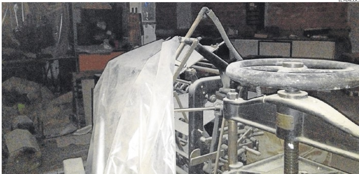
►► El deterioro que ha provocado el abandono de la maquinaria en el interior de la Imprenta Blasco obligará a hacer una labor de recuperación ahora.
